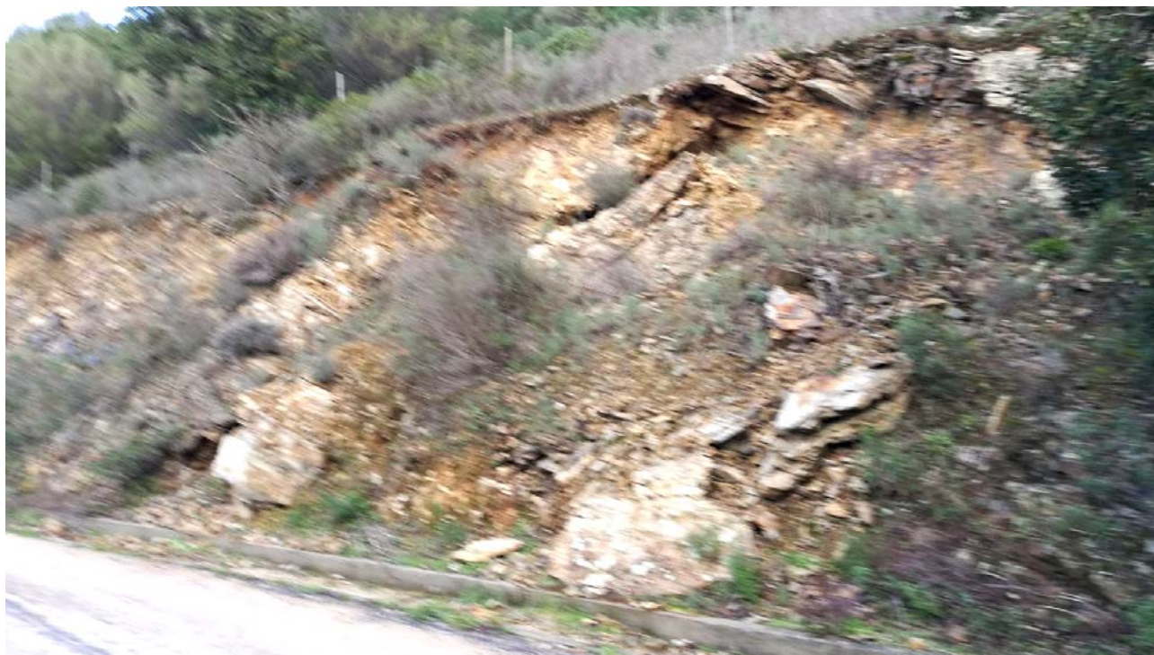
Foto – Uno dei tagli instabili lungo Strada Circumlacuale destra del Lago del Leni
